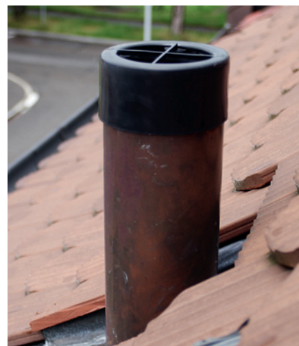
Heute verwendete Dunstrohre sind nicht isoliert, führen zu Wärmeverlusten und werden in den Normen energetisch noch nicht berücksichtigt.
